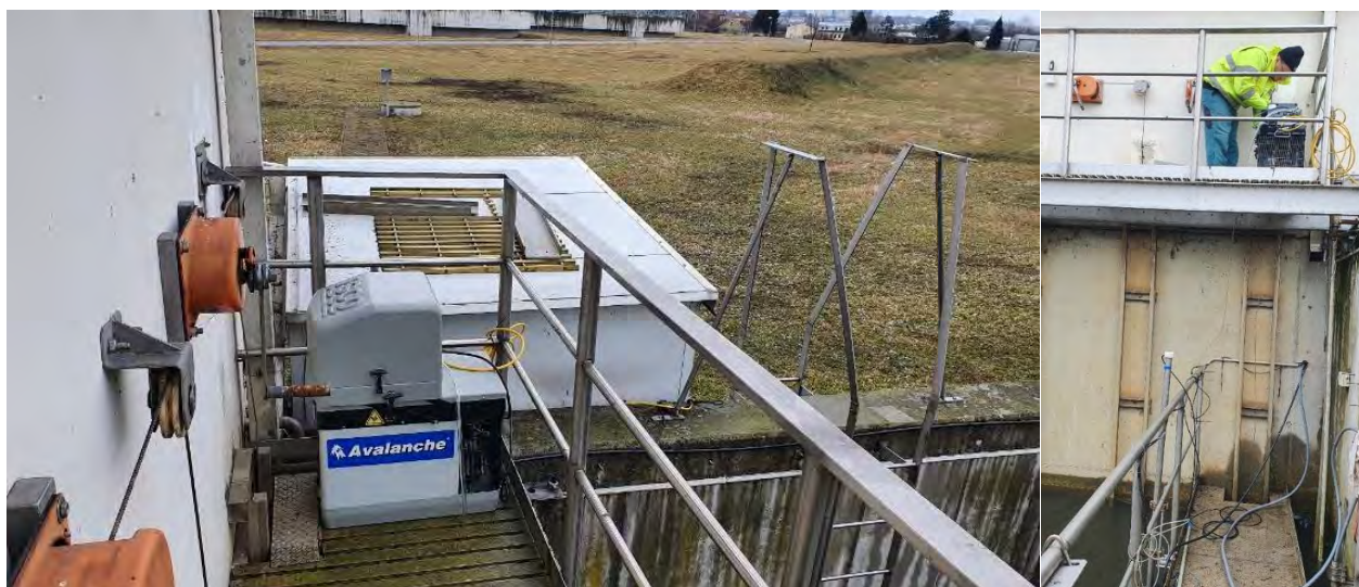
Obr. 10 Monitoring vyčištěné odpadní vody na odtoku z ČOV Brno-Modřice
