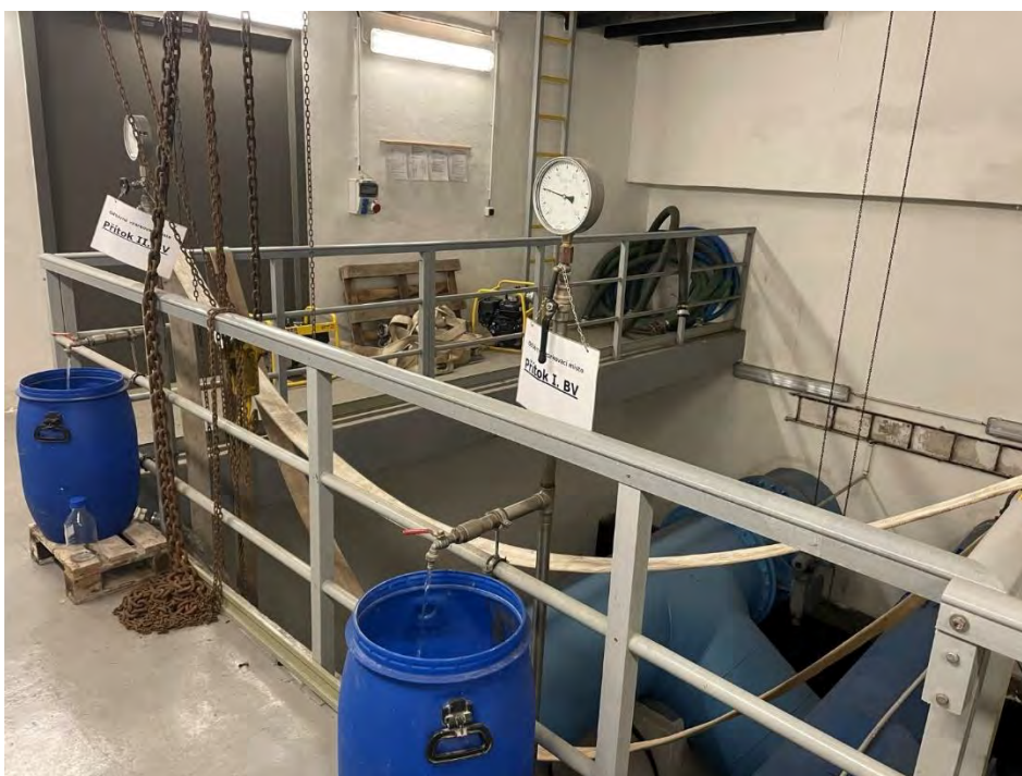
Obr. 7 Odběrné místo pro zdroj Březová nad Svitavou II. zdroj I. a II. horizont v armaturní komoře VDJ
